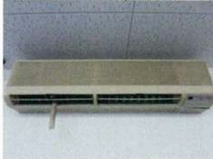
※技術センター (有機前処理室)
